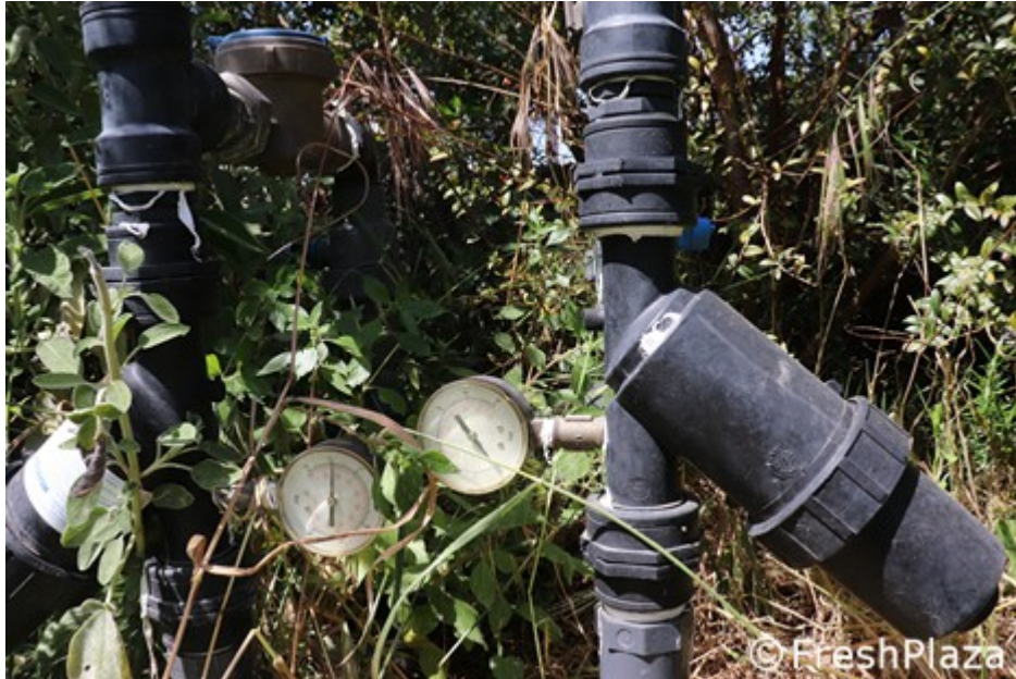
Centralina dell'acqua per la subirrigazione
